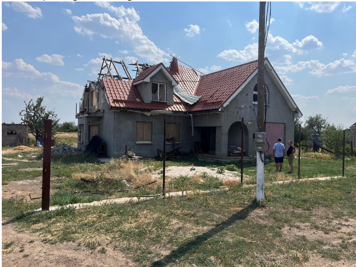
Figuur 2: Het droomhuis van Elena en Yvan. Wat in 10 jaar werd opgebouwd, werd in enkele minuten aan puin geschoten. – juli 2024
